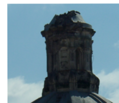
particolare della cupola danneggiata
